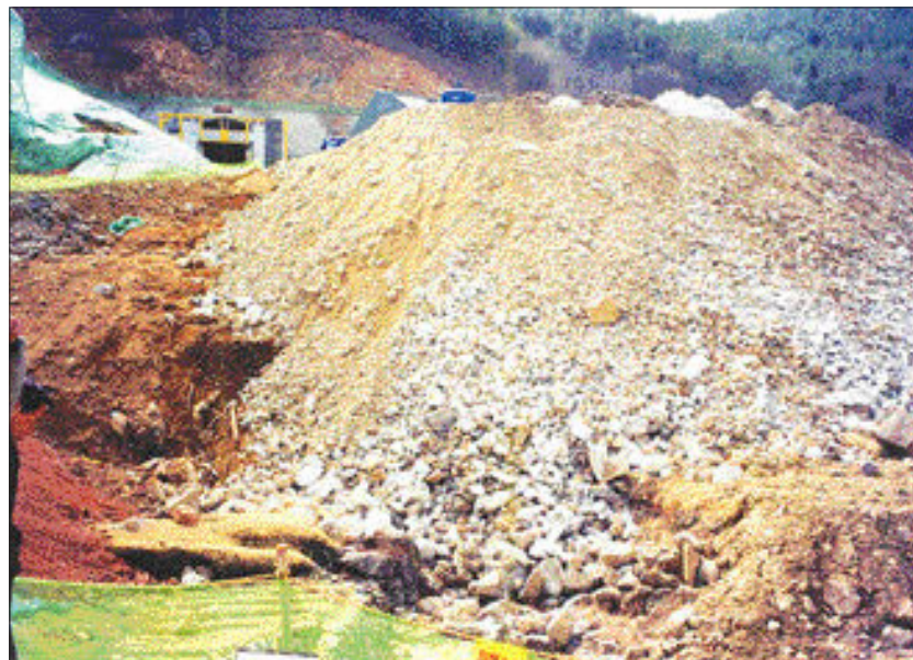
D건설이 전주~광양간 고속도로 공사를 하면서 토석을 매립해 식수로 사용하는 계곡물이 휴탕물로 변해 주민들이 큰 불편을 겪고 있는 복호마을을 공사현장.
