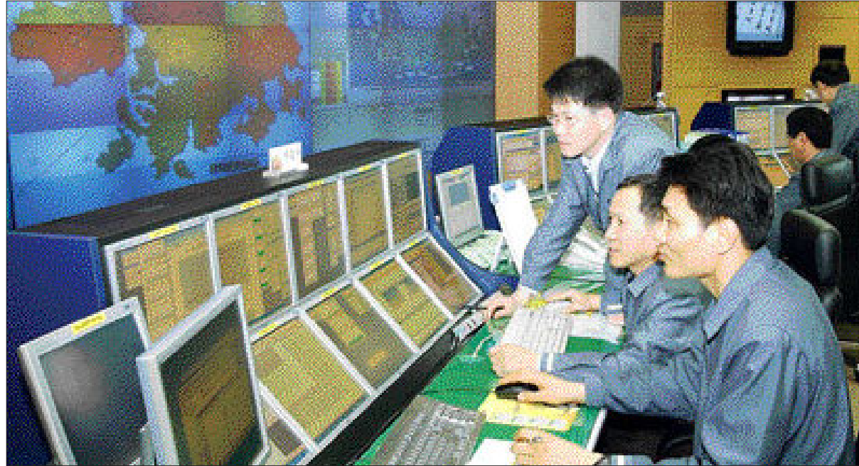
KT 전남 망관리센터' 직원들이 '망관리시스템'의 화면으로 전남 지역의 통신망을 지켜보고 있다. 이곳은 광주·전남 지역의 통신망에 대한 감시·제어·소통관리와 통화량 분석 및 예측 등의 역할을 하고 있다. /최현배기자 choi@kwangju.co.kr
