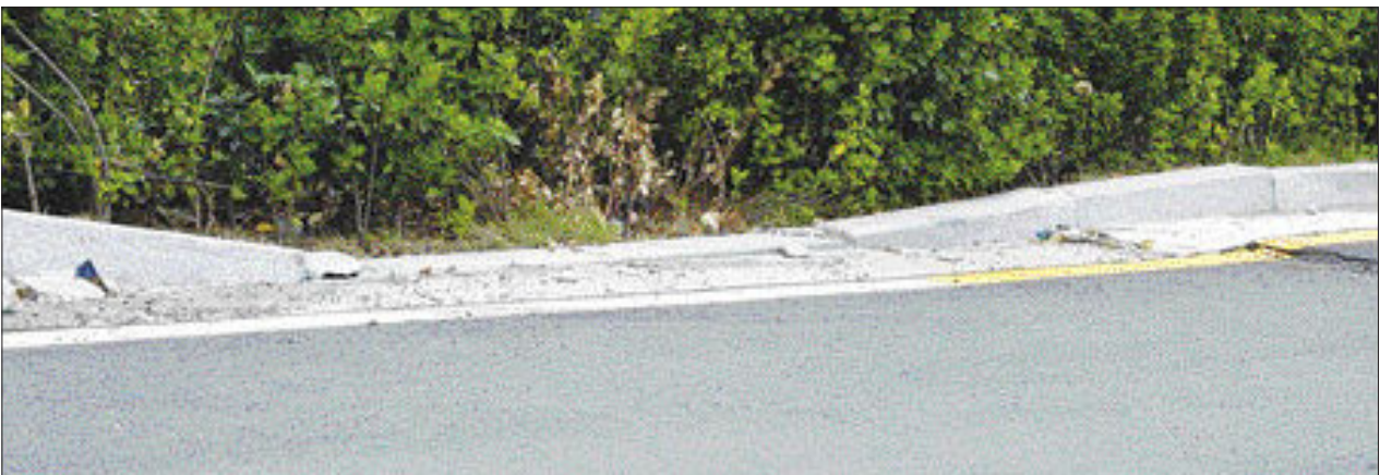
준공된 지 1년 된 광양항 매립지에 지난 침하가 진행되면서 이 매립지에 준공된 대형 활인점 주차장 경계석들이 마치 물결 모양으로 움푹 꺼져있고 도로도 패어 있다.
