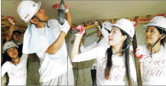
23일 오전 강원도 춘천시 헤비타트 사랑의 집짓기 공사현장인 신북읍 천전리에서 슈퍼모델 본선진출자와 ㈜두산 증가집 직원들이 자원봉사 활동을 펼치고 있다.
