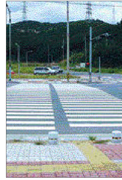
광양시 광영동 도촌마을 앞 산업도로가 8차선으로 확장되면서 육교가 철거돼 주민들이 교통사고 위험에 노출돼 있다. /광양=김춘희기자 chkim@
