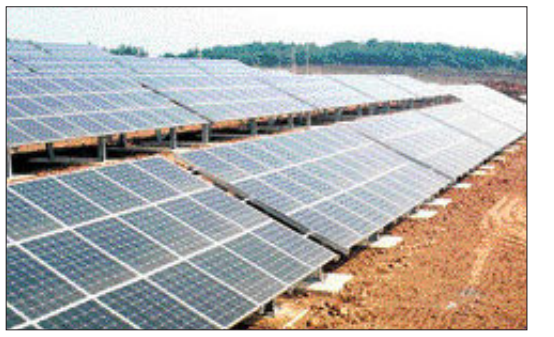
태양광 집열판(셀) 6천여개가 설치된 국내 최대 규모의 태양광 발전소 전경
