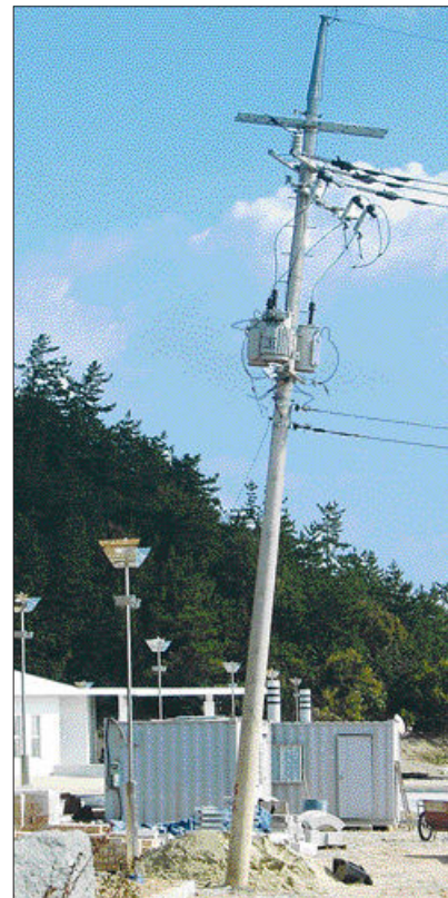
목포 관문인 옥림동 인공폭포와 현충탑 사이에 세워진 전봇대가 기울어져 있어 보수공사가 시급하다.
