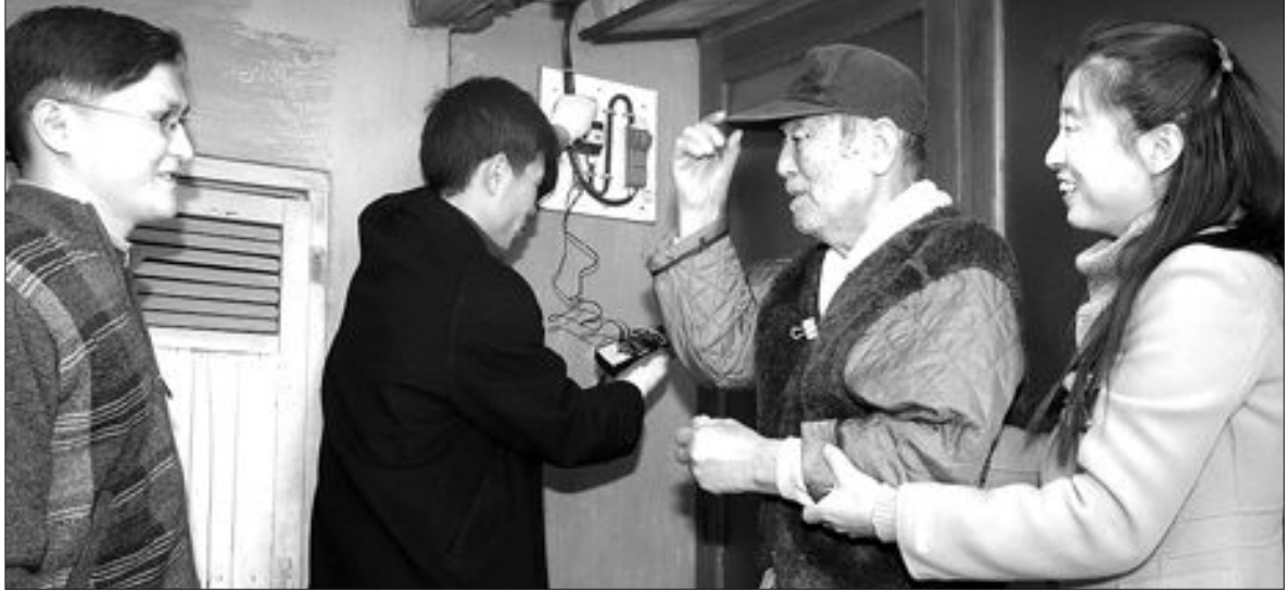
어르신 겨울나기 안전하게 광주시 서구청은 4일 전기·도목·건축 등 관련 분야 합동 점검팀을 구성, 관내 독거 노인과 기초생활수급자 등이 안전한 겨울을 보낼 수 있도록 전기설비와 건축을 주변 측대 및 용역의 안전상태에 대한 점검을 벌였다. /나명주기자 mjna@kwangju.co.kr
