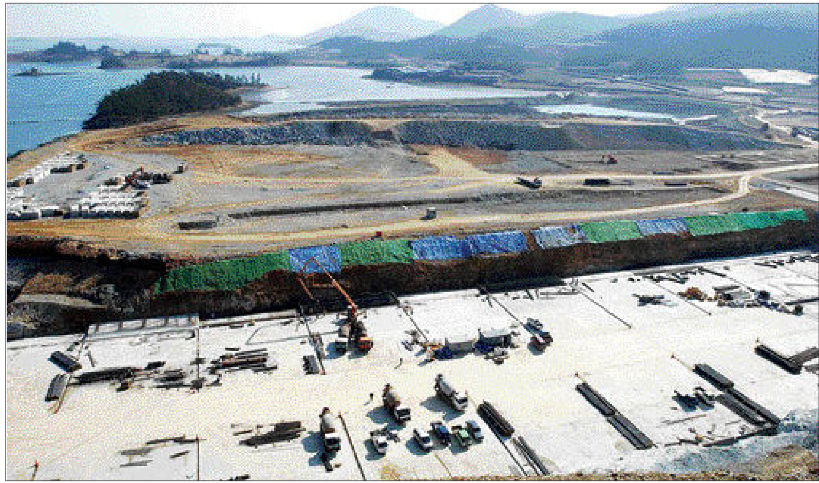
유용 드러낸 제1도크 건설 현장 해남군 화원반도에 위치한 대한조선이 세계 최대의 도크시설을 구축, '글로벌 넘버원' 조선기업으로 거듭나기 위한 대대적인 프로젝트를 진행하고 있다. 오는 7월부터 선박 건조에 들어갈 예정인 제 1도크 건설 장면. /위정량기자 jrwi@kwangju.co.kr
