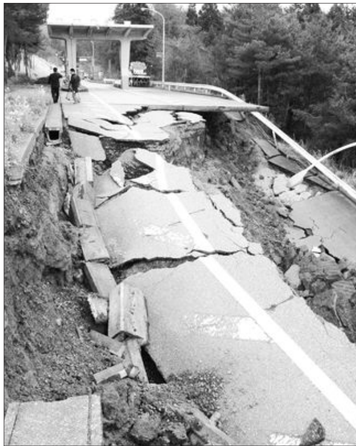
일본 이시카와현 노토지역 유료도로 부스 근처의 도로 지반이 지진으로 내려앉았다. 이번 지진은 12년 전 한신대지진에 필적하는 수준으로 측정됐다.
