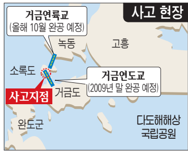
이날 사고는 11m높이의 공사장에서 콘크리트 타설 작업을 하던 중 갑자기 거푸집이 무너지면서 상판과 철골 구조물까지 잇따라 붕괴된 것으로 알려졌다.
