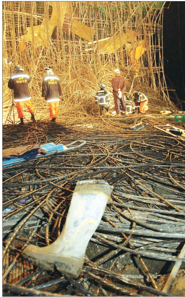
119구조대원들이 5일 밤 11시께 고흥 소록도 연도교 붕괴 사고 현장에서 구조·수색작업을 벌이고 있다. 주인을 잃은 장화가 철골 구조물 위에 버려져 있다. /녹동=남명주기자 mjna@kwangju.co.kr
