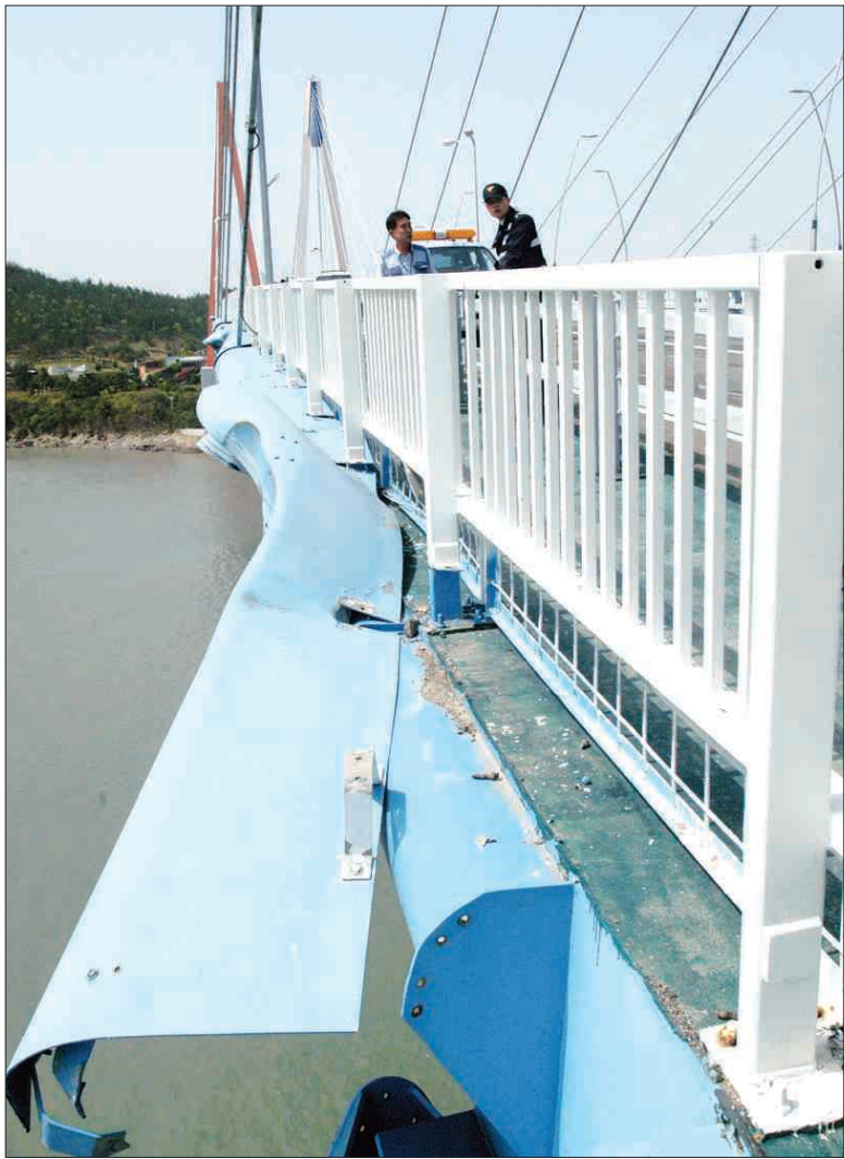
지난 22일 밤 시험조류발전소 대형 철 구조물을 싣고가던 바지선과 충돌, 부어진 '진도 제1대교'. 수심 14.5~24.5m 깊이의 울돌목(鳴梁海峽)은 해협 폭이 294m로 좁은데다, 유속이 최고 11노트(시속 20km)를 넘어 잦은 해난 사고가 일어난다. /진도=최현배기자 choi@kwangju.co.kr
