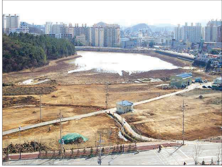
순천시와 한국농촌공사 법적 공방을 벌이게 된 왕조·운곡지구 공사 현장. 지난해 7월 착공돼 현재 32%의 공정을 보이고 있다.
