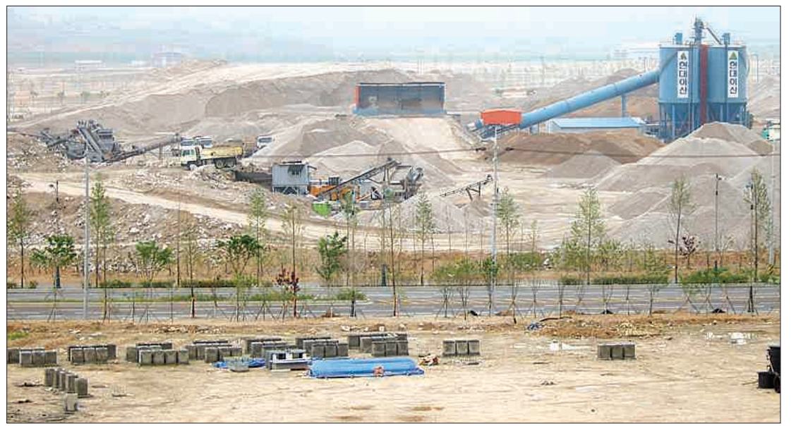
100만평 규모의 1단계 부지 조성이 마무리된 개성공단 현장에서 지난달 29일 시공사인 현대아산측이 각종 건설장비를 동원, 골재 파쇄와 콘크리트 혼합작업을 벌이고 있다.
