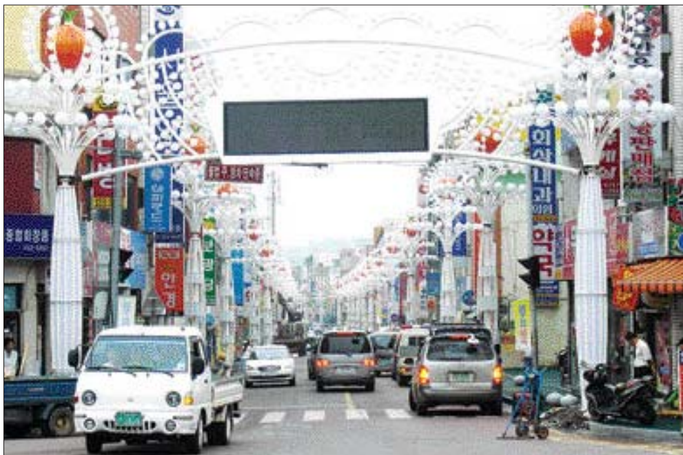
무안군이 최근 읍 시가지에 30여개의 LED 조명등을 설치해 새로운 야간 볼거리로 기대를 모으고 있다. /무안=이원희기자 whlee@
