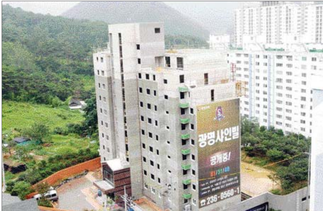
광주시 동구 운림동에 신축 중인 '광명사인빌' 아파트. 맞은편에 있는 리인광명아파트 주민들은 지난해 무등산 조망권을 해친다며 건설사 측에 항의해 층 수를 낮췄다.
