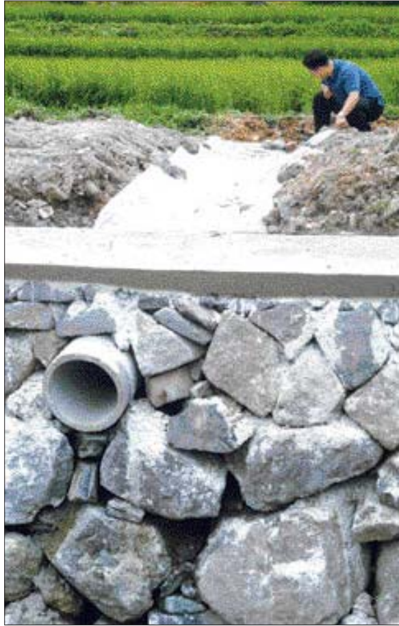
동산천 제방 부실공사 현장
