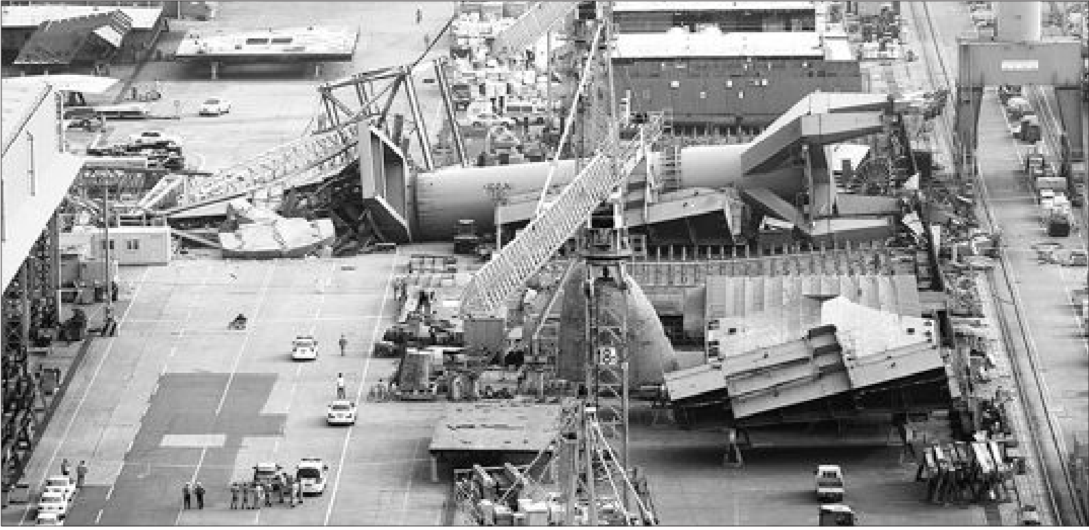
영암군 삼호읍 현대 삼호조선소 제1도크 대조립부 작업장에서 타워 크레인을 설치하던 중 넘어진 600t급 '지브(Jib)'크레인 등이 넘어져 조선소 야외작업장을 크게 파손. 전해가 어지럽게 널려있다. /위직량기자 jrwi@kwangju.co.kr
