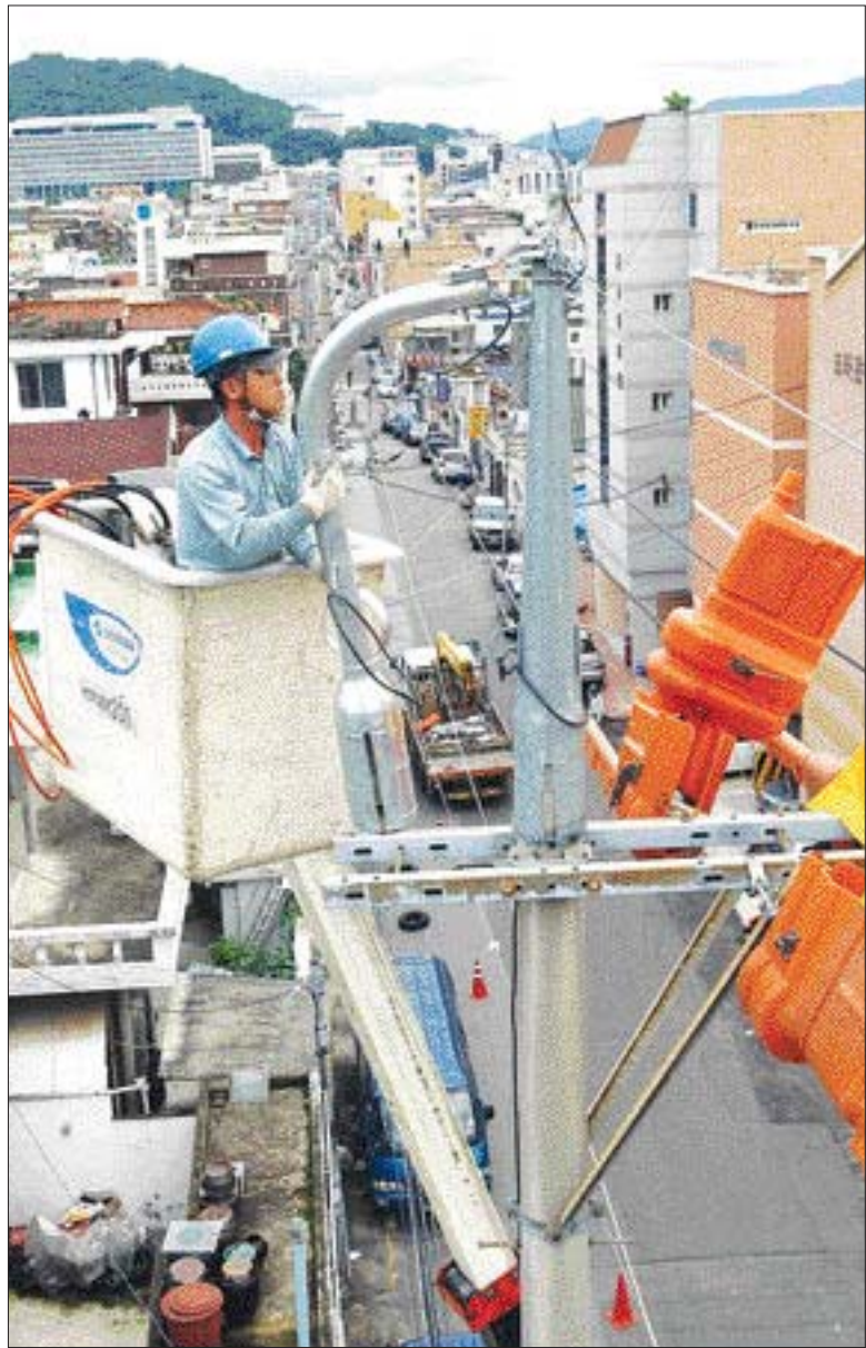
한전 전남사업본부 직원들이 7일 오후 광주시 북구 두암동에서 전신주에 벼락이 떨어지는 것을 막기 위해 피뢰침 역할을 하는 ‘편출형 지지대’를 설치하고 있다. /위직림기자 jrvi@kwangju.co.kr
