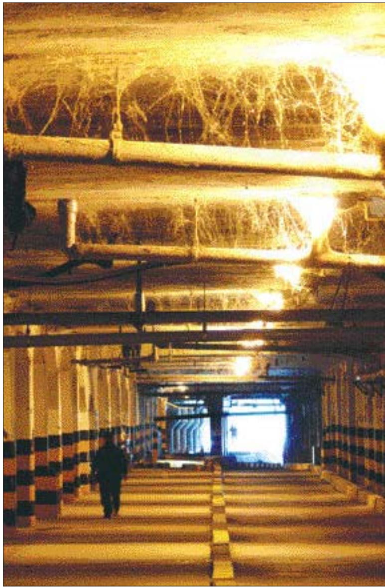
‘공포의 주차장’ 거미줄과 매연으로 뒤덮인 광주시 서구 양동복개상가 하부주차장. 내부가 너무 컴컴하고 CCTV 등 보안시설이 전무, 상가를 찾는 운전자들이 이용을 꺼리고 있다. /인현주기자 ahj@kwangju.co.kr
