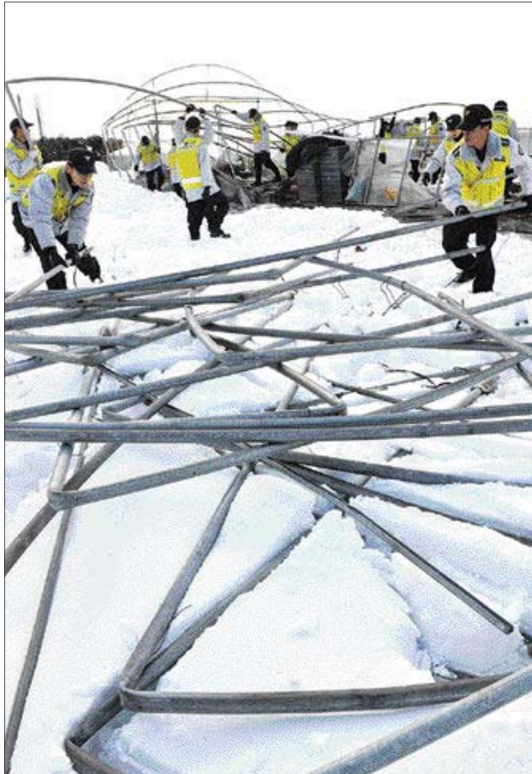
폭설 붕괴 비닐하우스 복구 광주 서부경찰서 방법순찰대와 112 타격대 소속 대원 50명은 2일 폭설로 붕괴된 광주시 서구 유덕동 방울 토마토 재배 비닐하우스에서 시설물 복구 작업을 벌였다.
