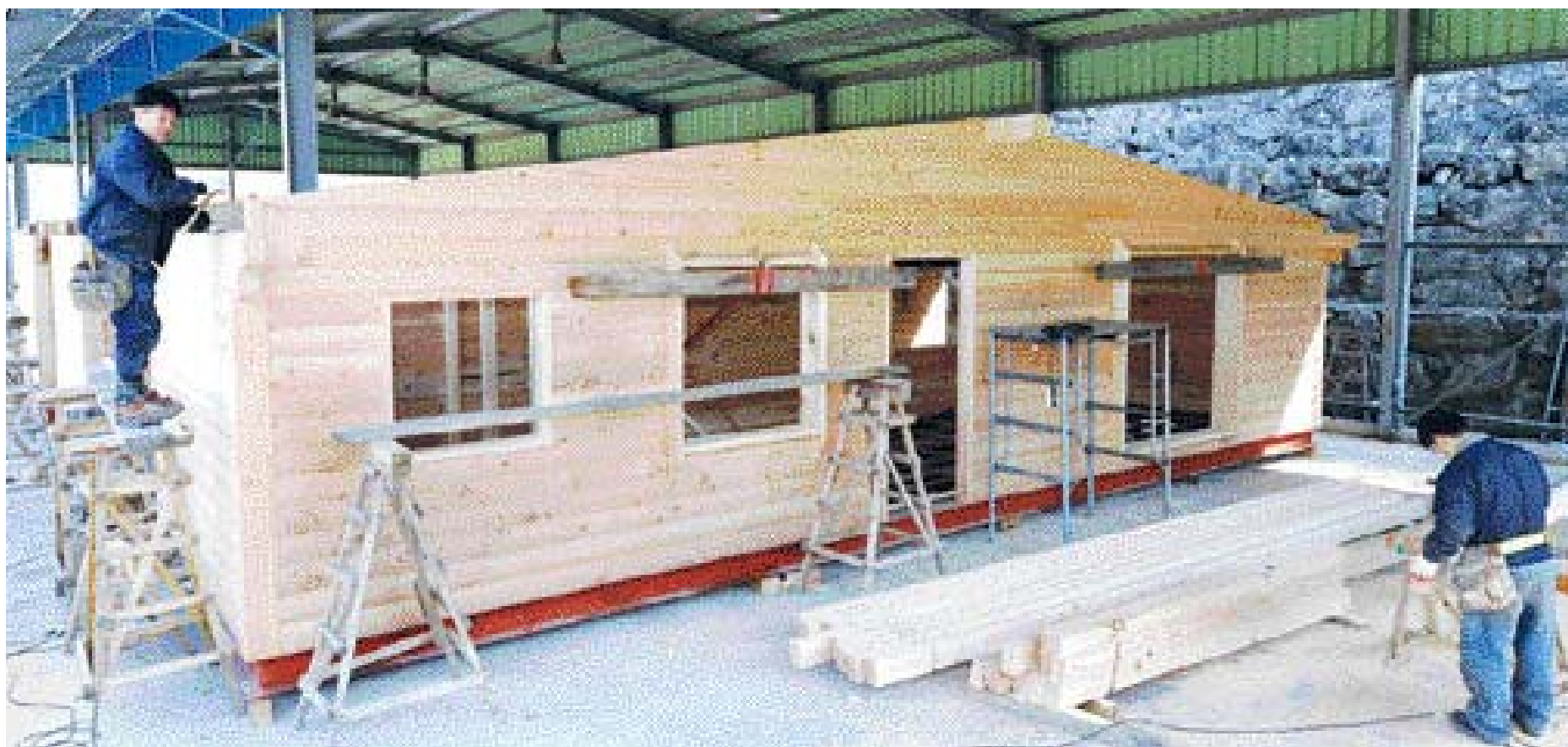
한국목재산업(주) 직원들이 이동식 통나무집을 짓고 있다. 일반인들이 통나무집을 직접 지으려면 건축 교육기관 등을 통해 기술을 먼저 익히는 것이 중요하다.
