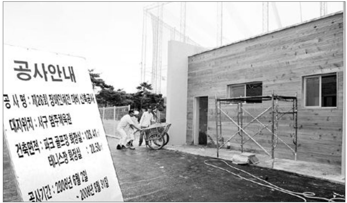
오는 10월 열리는 제28회 전국장애인체육대회를 맞아 광주시 서구 염주체육관 인근에 조성중인 파크골프 경기장의 마무리 공사가 한창이다. 파크골프는 골프와 경기방식이 유사하며, 이 경기장은 대회가 끝난 뒤 장애인과 노약자들의 공간으로 개방된다. /최현배기자 choi@kwangju.co.kr
