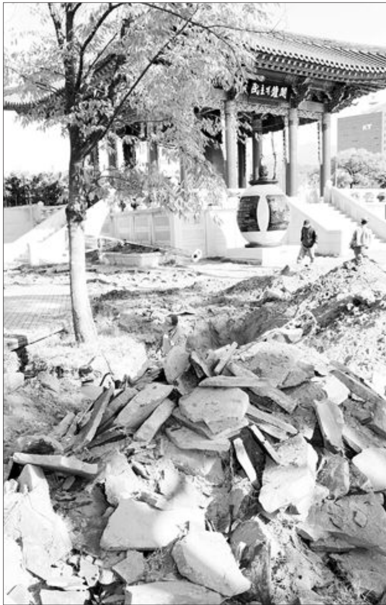
‘민주의 종각’ 소공원 철거 28일 광주시 동구 금남로 옛 전남도청 앞에 설치된 ‘민주의 종각’ 소공원이 철거되고 있다. 이 소공원은 지난 2005년 10월 현 위치에 조성됐으나 이 일대에 국립아시아 문화전당의 지하 주차장이 조성될 예정이어서 철거된다. 민주의 종각과 민주의 종은 광주시 환경시설공단에 보관된 후 2010년 3월까지 현 위치에 복원될 예정이다.
