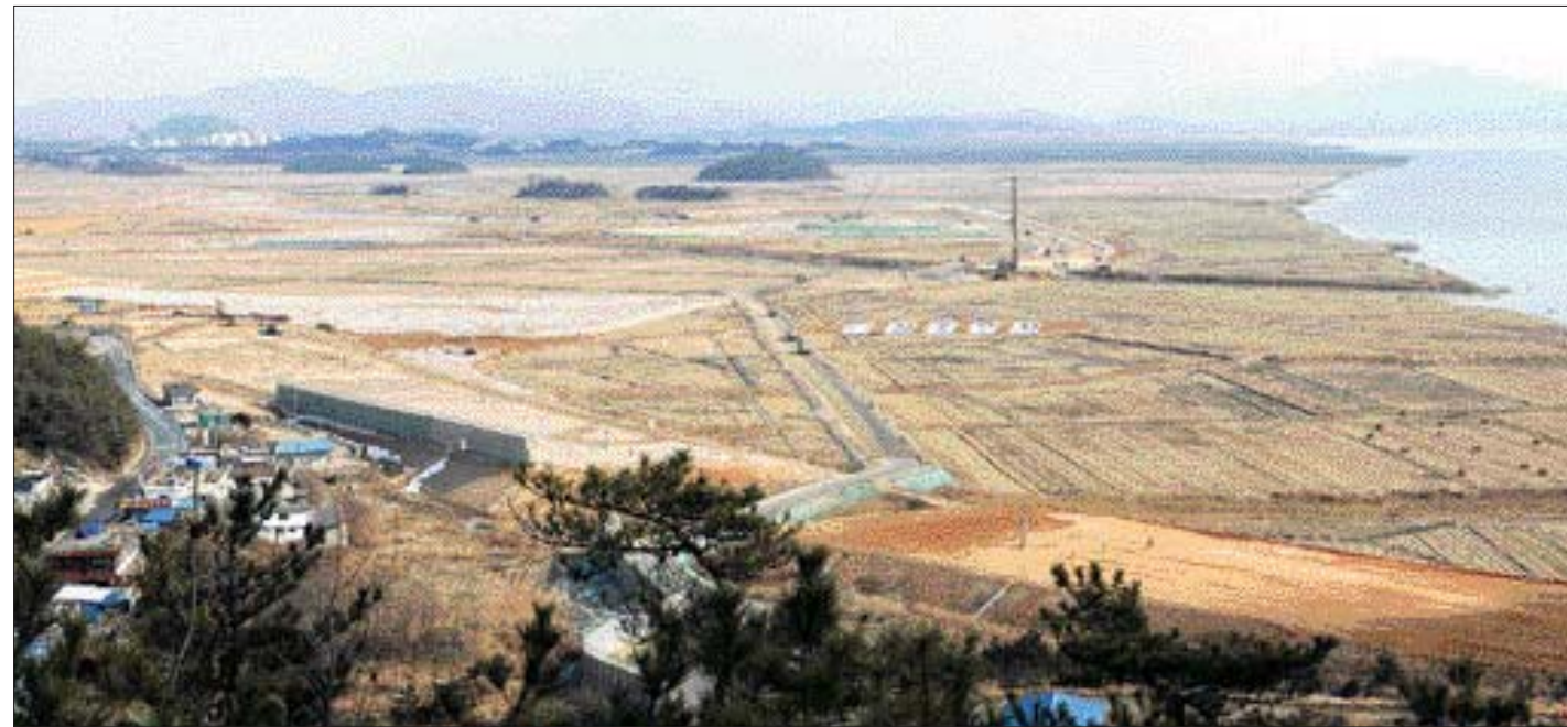
영암군 삼호읍 삼포리와 난전리 간척지 일원에서 진행되고 있는 F1대회 경주장 건설이 한창이다. 현재 43%의 토목 공정률을 보이는 등 공사가 차질없이 진행중이다.
