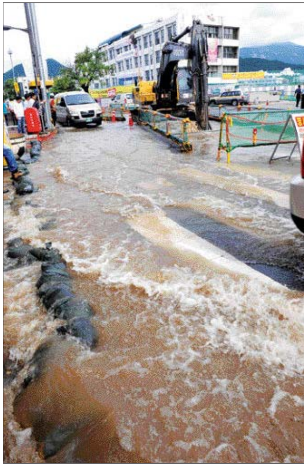
28일 오후 광주시 동구 총장로 1가 입구 양복 4차선 도로에서 하수관 매설을 위해 땅을 파던 굴삭기가 상수도관을 파열시켜 수돗물이 치솟는 바람에 1시간 이상 이 일대가 큰 혼잡을 빚었다.
