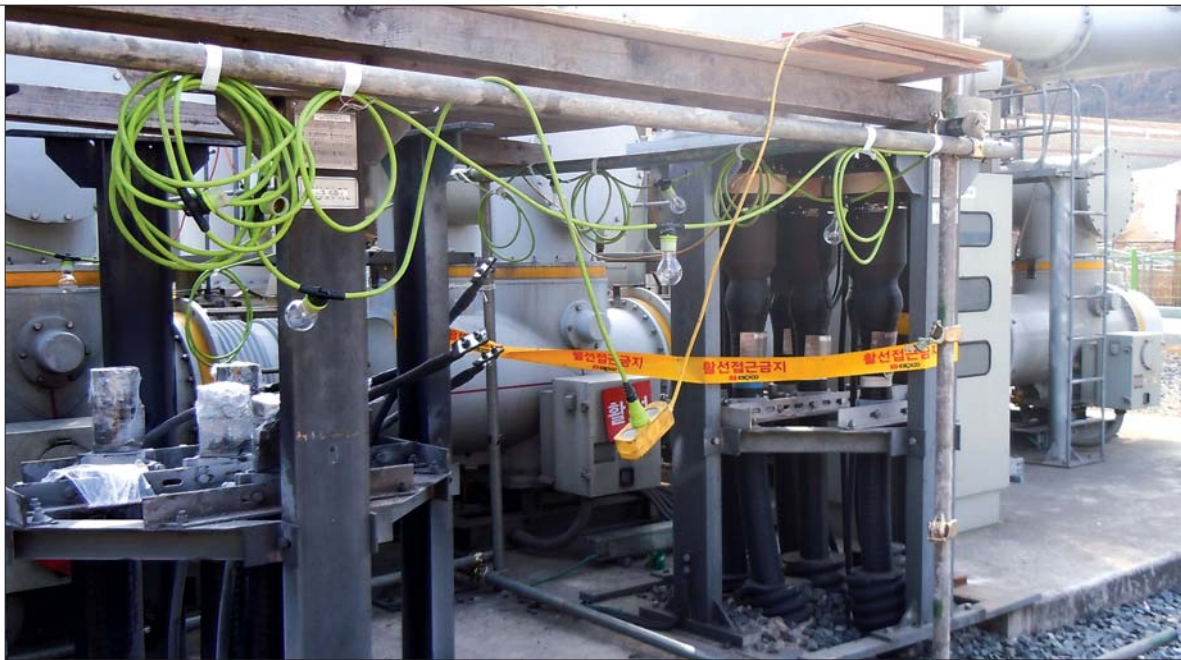
지난 17일 오후 여수산단 정전 사고를 일으킨 여수화력발전처 내 가스절연개폐장치. 사진 왼쪽은 사고가 발생한 용성변전소 선로이며, 오른쪽은 GS칼텍스의 2번 선로다.
