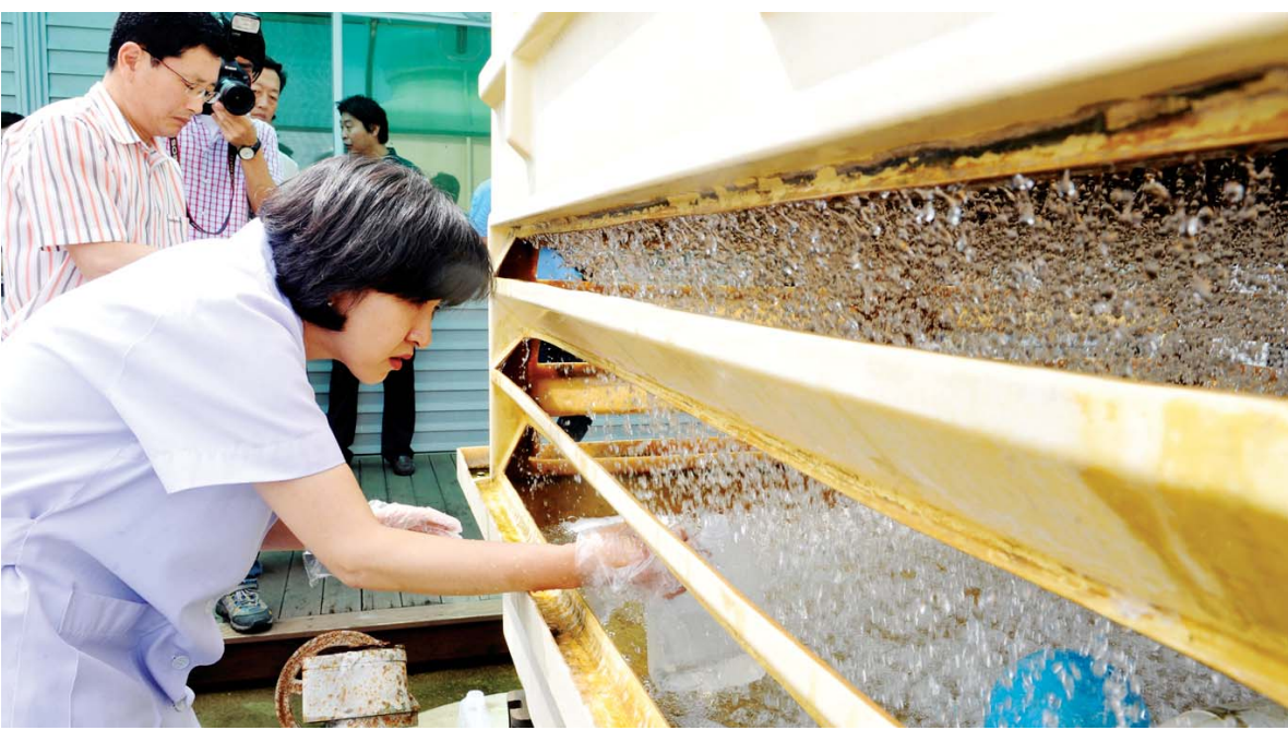
냉각탑 시료 채취 광주시 북구 보건소 직원들이 4일 용봉동 청사 별관 옥상 냉각탑에서 호흡기 질환을 일으키는 레지오넬라균 검출 여부 확인을 위해 시료를 채취하고 있다. /김진수기자 jeans@kwangju.co.kr
