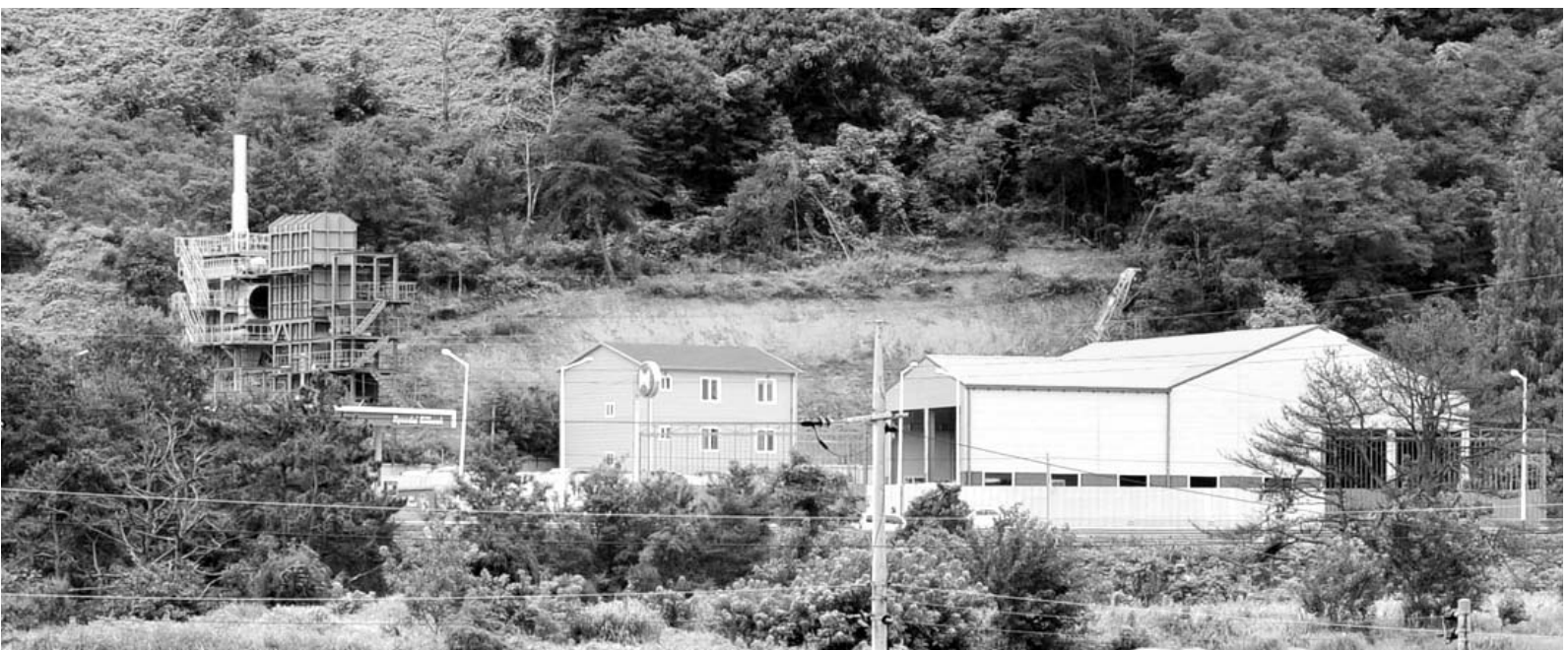
15일 광주시 남구 양과동 개발제한구역에 건축중인 의료폐기물 소각시설(왼쪽) 바로 옆에 건축폐기물 처리시설(가운데)과 음식폐기물 처리시설이 잇따라 들어서 있다.
