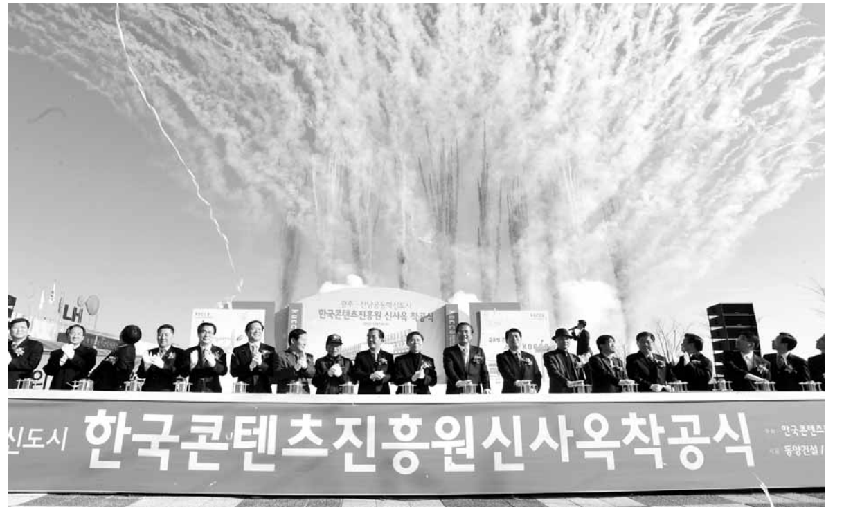
혁신도시 한국콘텐츠진흥원 신사옥 착공 주 광주·전남공동혁신도시내 LH홍보관 광장에서 열렸다. 박준영 전남지사와 홍상표 한국콘텐츠진흥원장 등 참석자들이 발파 버튼을 누르고 있다. /김진수기자 jeans@kwangju.co.kr
