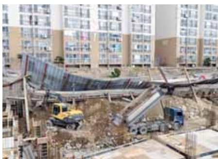
신안비치아파트 주차장 붕괴
