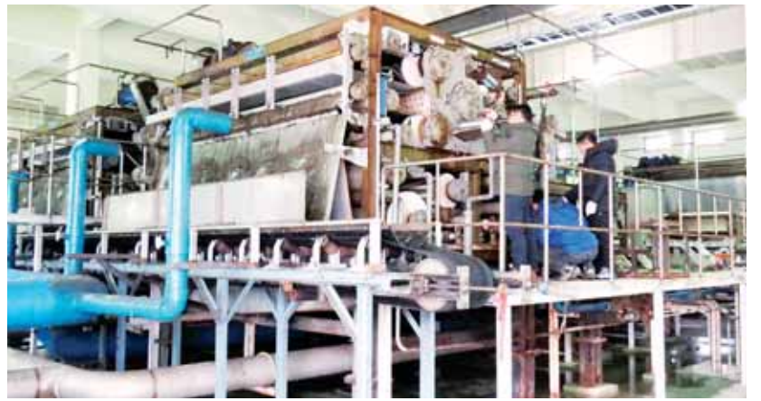
목포 북항 하수처리장 내 ‘벨트프레스 탈수기’. 가동된 지 13년이 지나 고장이 잦은데다가 벨트로 압축해 처리하기 때문에 약취도 심각한 상태다.
