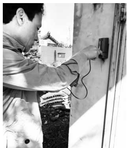
상수도 원격검침시스템 설치 모습.
