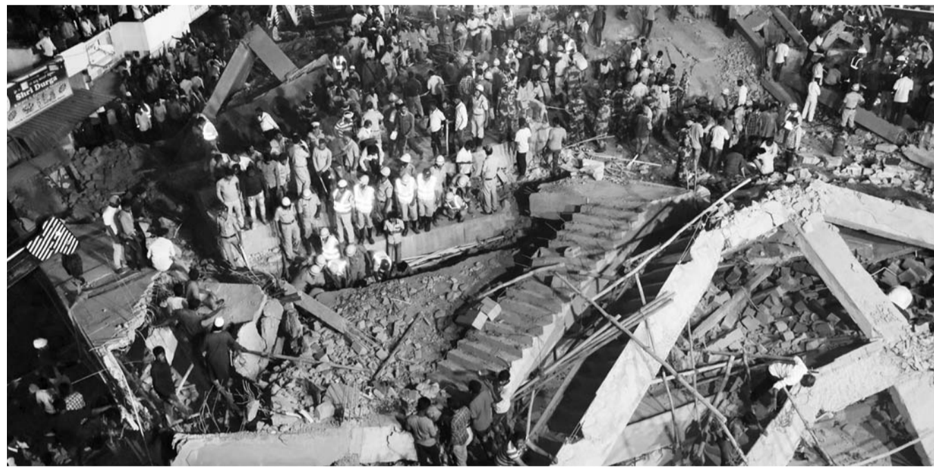
인도 다르와드 건물 붕괴 수십명 매몰 19일(현지시간) 인도 남서부 카라나타카주(州) 다르와드 지역의 건물붕괴 사고 현장. 구조대원들이 인명 구조 및 수색 작업을 벌이고 있다. 이날 다르와드에 있는 5층 건물 신축 공사현장이 무너져 최소 2명이 숨지고 수십명이 매몰됐다. /연합뉴스
