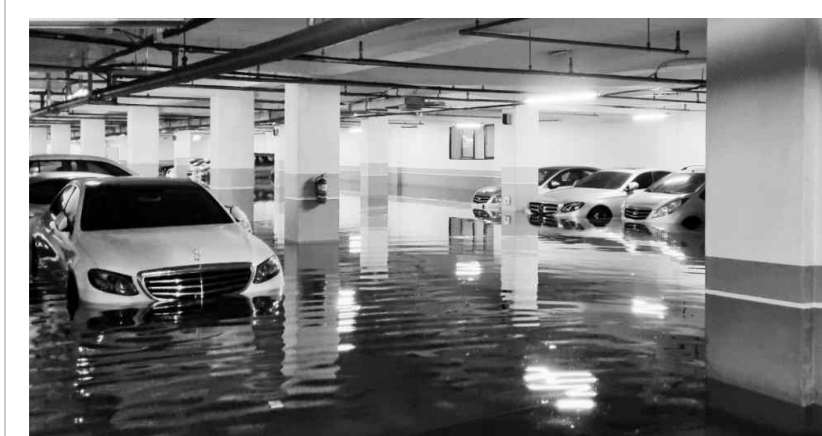
물에 잠긴 아파트 지하주차장 지난 30일 오전 6시께 광주시 남구 봉선동 한 아파트 지하주차장에 물이 차 오르면서 주차된 차량 20여대가 침수 피해를 입었다. 남구와 소방당국은 이날 지하 저수조에서 옥상 물탱크로까지 연결된 배관이 부식, 파손되면서 흘러나온 물로 침수피해가 발생한 것으로 추정하고 정확한 경위를 조사중이다. <남부소방 제공>
