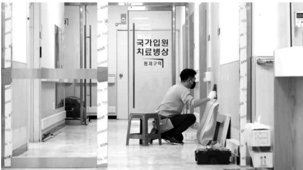
21일 오전 광주 동구 조선대학교병원 음압격리병동에서 작업자가 코로나19 중증중 환자 병상 확충을 위해 공간 확보 공사를 하고 있다.
