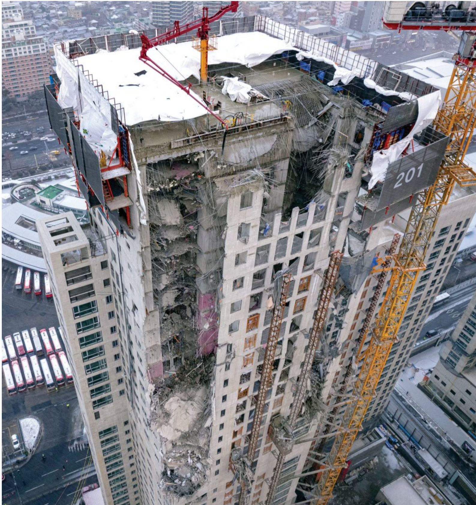
11일 오후 건물 외벽과 바닥층 등이 무너져 내린 광주시 서구 화정동 아이파크 아파트 외관. 폭격을 맞은 듯 34~23층 외벽이 철골 구조를 드러냈다. 건물 옆에 설치된 140m 높이의 타워크레인이 기울어져 넘어질 듯 위태로워 보인다. /김진수 기자 jeans@kwangju.co.kr
