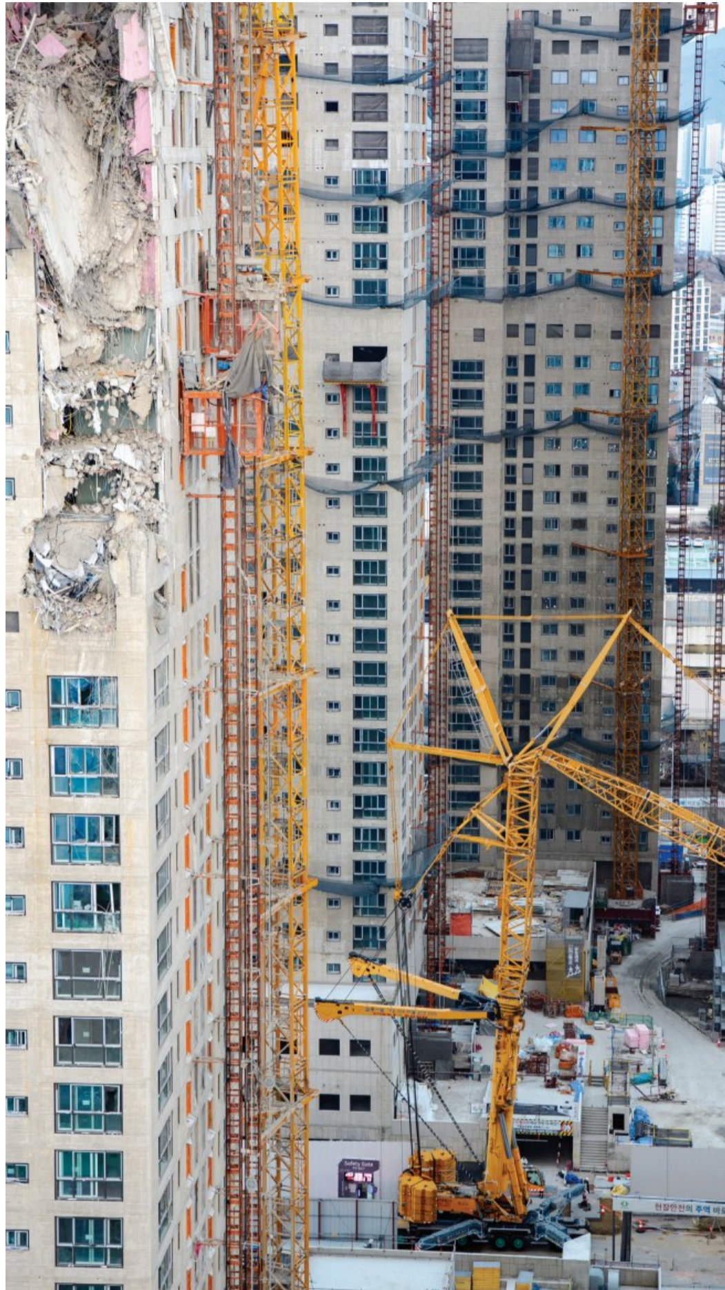
붕괴 현장 이동 크레인 설치 광주 서구 화정동 아이파크 아파트 붕괴사고 발생 6일째인 16일, 아파트 외벽에 위태롭게 매달린 타워크레인을 해체하기 위해 설치 중인 이동 크레인이 차츰 모습을 드러내고 있다. /김진수 기자 jeans@kwangju.co.kr
