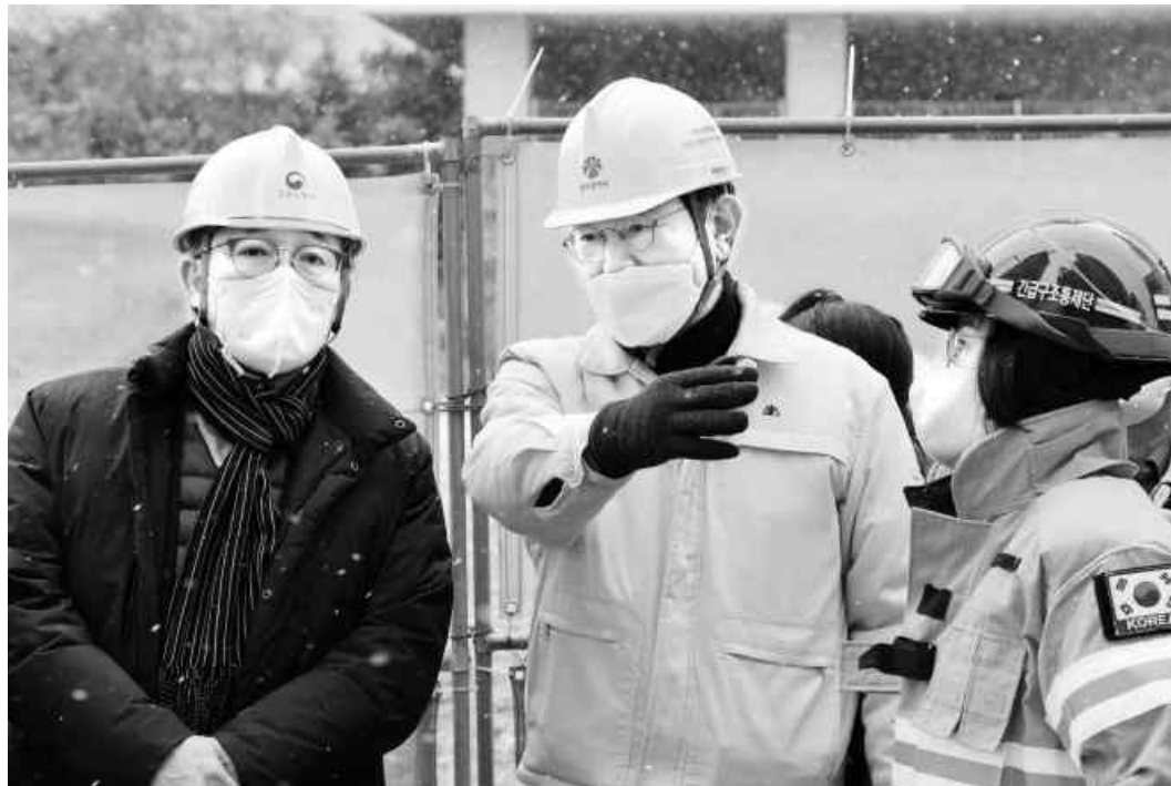
이용섭 광주시장이 서구 화정동 현대산업개발 아이파크 아파트 신축공사 붕괴사고 현장에서 수습대책을 점검하고 있다.
