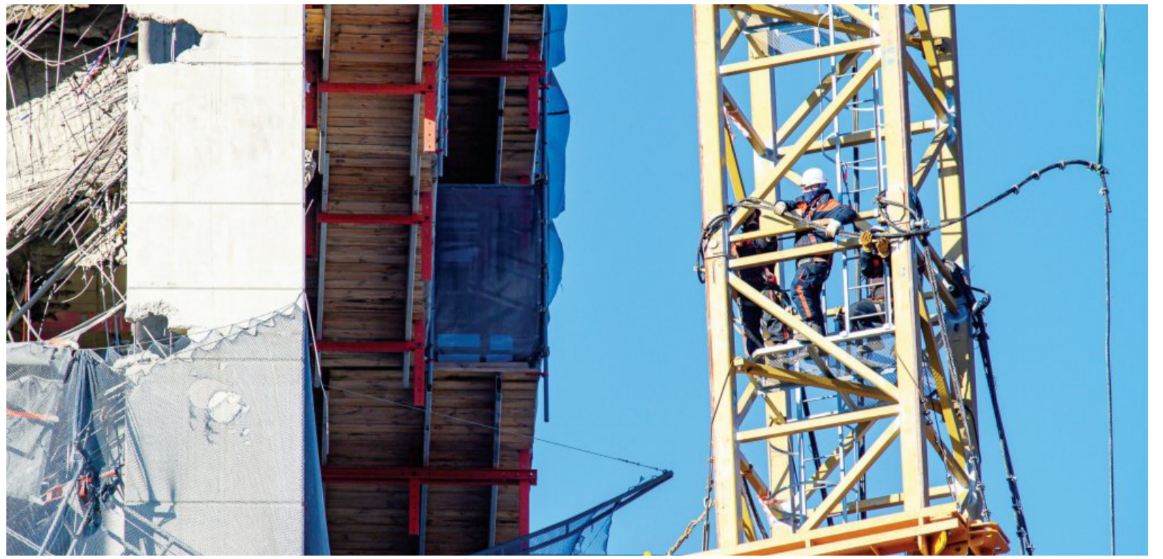
광주시 화정아이파크 붕괴사고 8일째인 18일 오후, 붕괴동의 휘어진 크레인 보강작업을 위해 작업자들이 34층 높이에 올라가 고강도 와이어를 설치하고 있다. /김진수 기자 jeans@kwangju.co.kr
