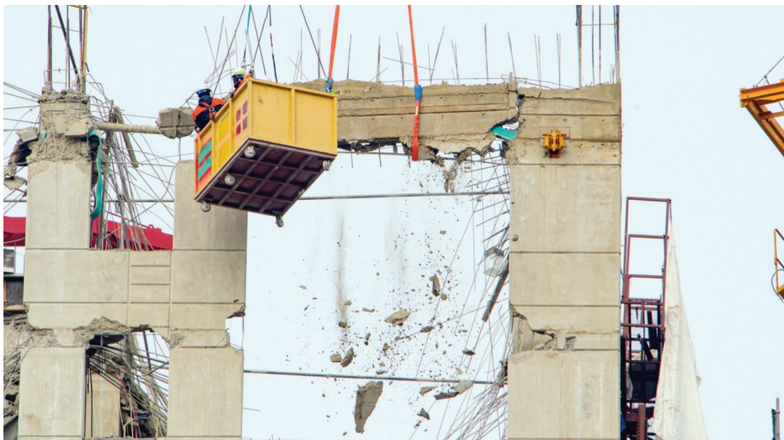
23일 오후 광주 서구 화정아이파크 붕괴 현장에서 작업자들이 상층부 붕괴 위험이 있는 외벽 일부분을 떼내고 있다. 작업 도중에도 콘크리트 잔해물들이 떨어지고 있다. /김진수 기자 jeans@kwangju.co.kr
