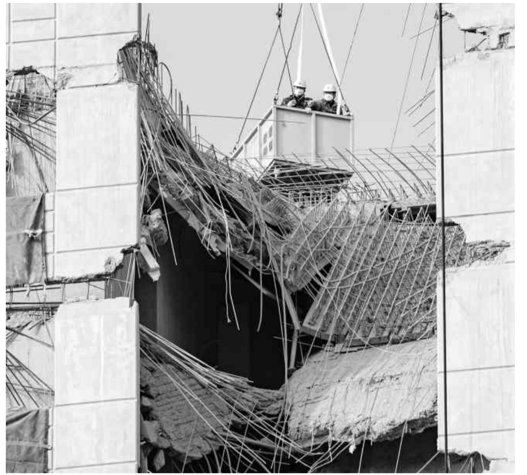
광주 화정 아이파크 붕괴사고 16일째를 맞는 26일 오후, 작업 관계자들이 타워크레인에 설치된 바스켓을 타고 쏟아져내린 슬래브와 외벽 등의 상황을 살펴보고 있다. /김진수 기자 jeans@kwangju.co.kr
