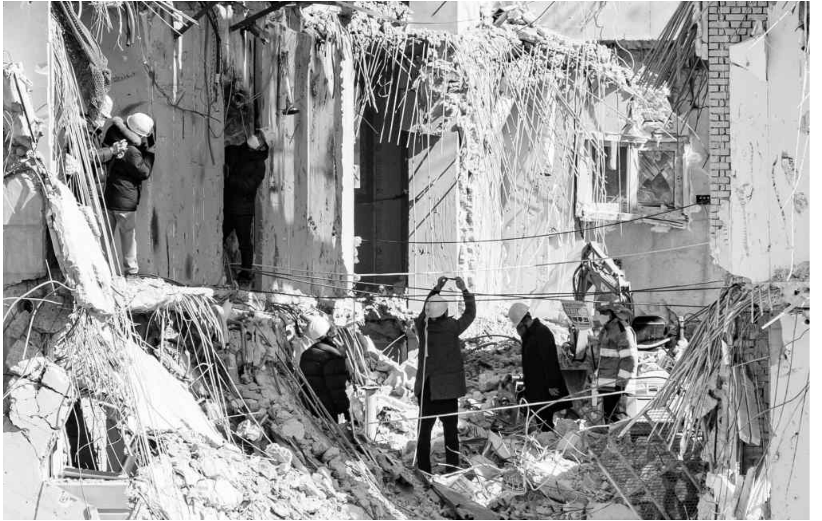
광주 서구 아이파크 붕괴사고 24일째를 맞은 3일, 국토안전관리원 등의 전문가 자문단이 지난 2일 추가 붕괴가 발생한 29층과 28층 지역을 찾아 안전성 여부를 확인하고 있다. /김진수 기자 jeans@kwangju.co.kr
