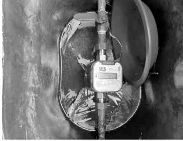
디지털 방식의 상수도 원격 검침기가 설치된 계량기함 내부 모습.
