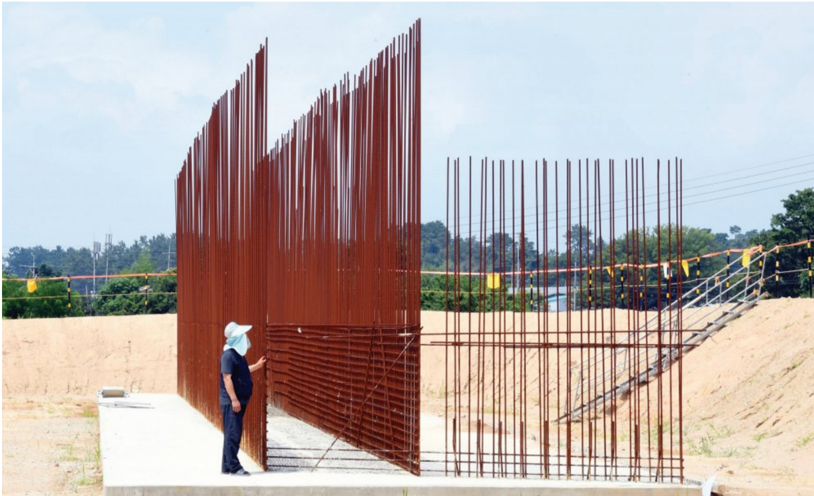
예술작품 아닙니다, 고속도로 공사 현장 녹슨 철근 5일 광주~완도간 고속도로 공사가 진행 중인 광주시 남구 대촌니들목 부근 공사 현장에 철근이 녹슨채 장기간 방치돼 있어 공사안전에 대한 우려가 제기되고 있다. 일반적으로 도로 공사 현장에서는 자체나 시공 상태의 철근과 관련한 공사가 중단될 경우, 녹방지 커버 등을 씌워 철근의 부식을 방지하고 있다. /나명주 기자 mjna@kwangju.co.kr
