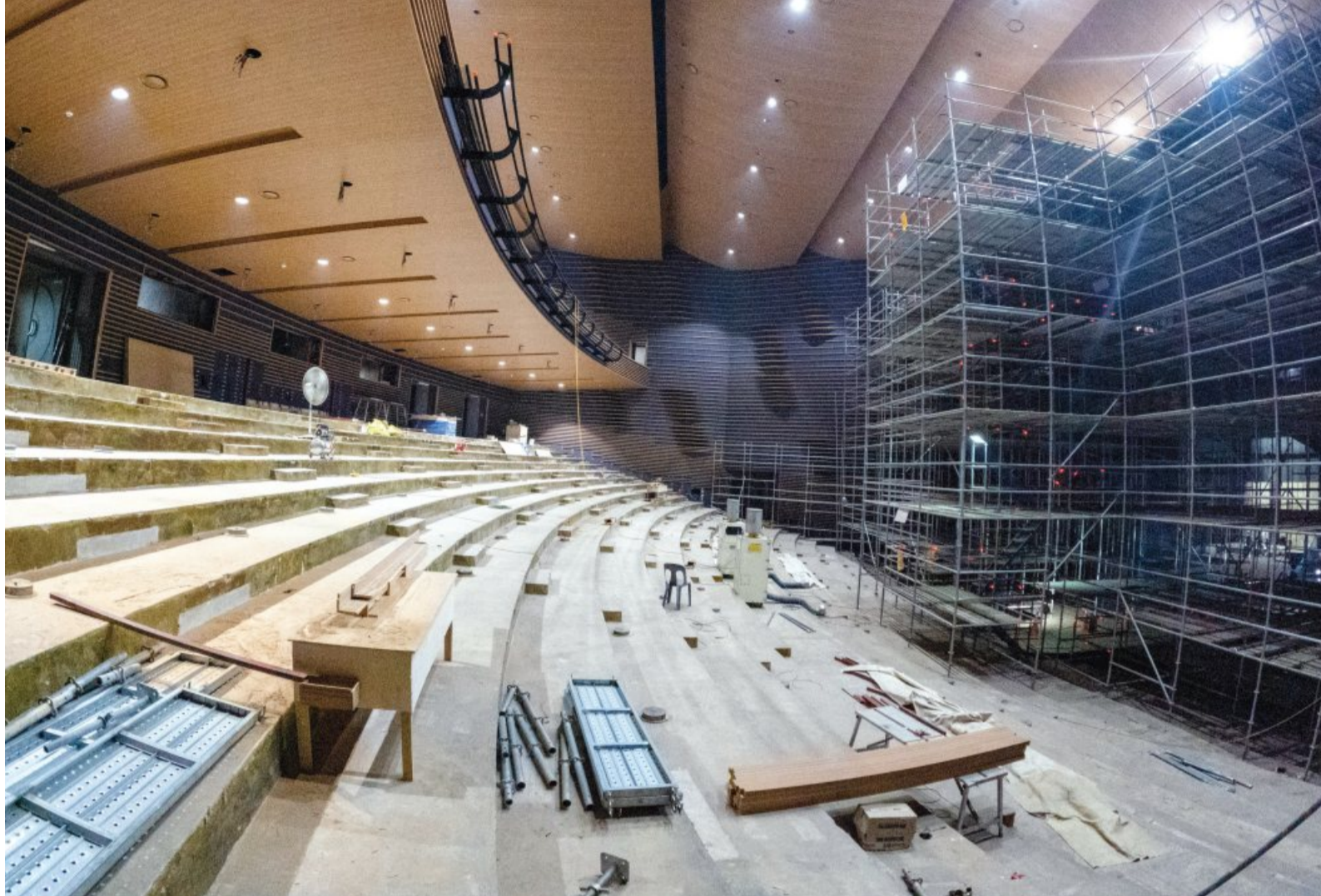
지난 1991년 개관한 광주의 대표 문화시설인 문화예술회관이 노후화로 인해 리모델링이 진행 중이다. 현재 공정률은 70%로 2023년 3월까지 공사를 완료할 예정이다. /김진수 기자jeans@kwangju.co.kr
