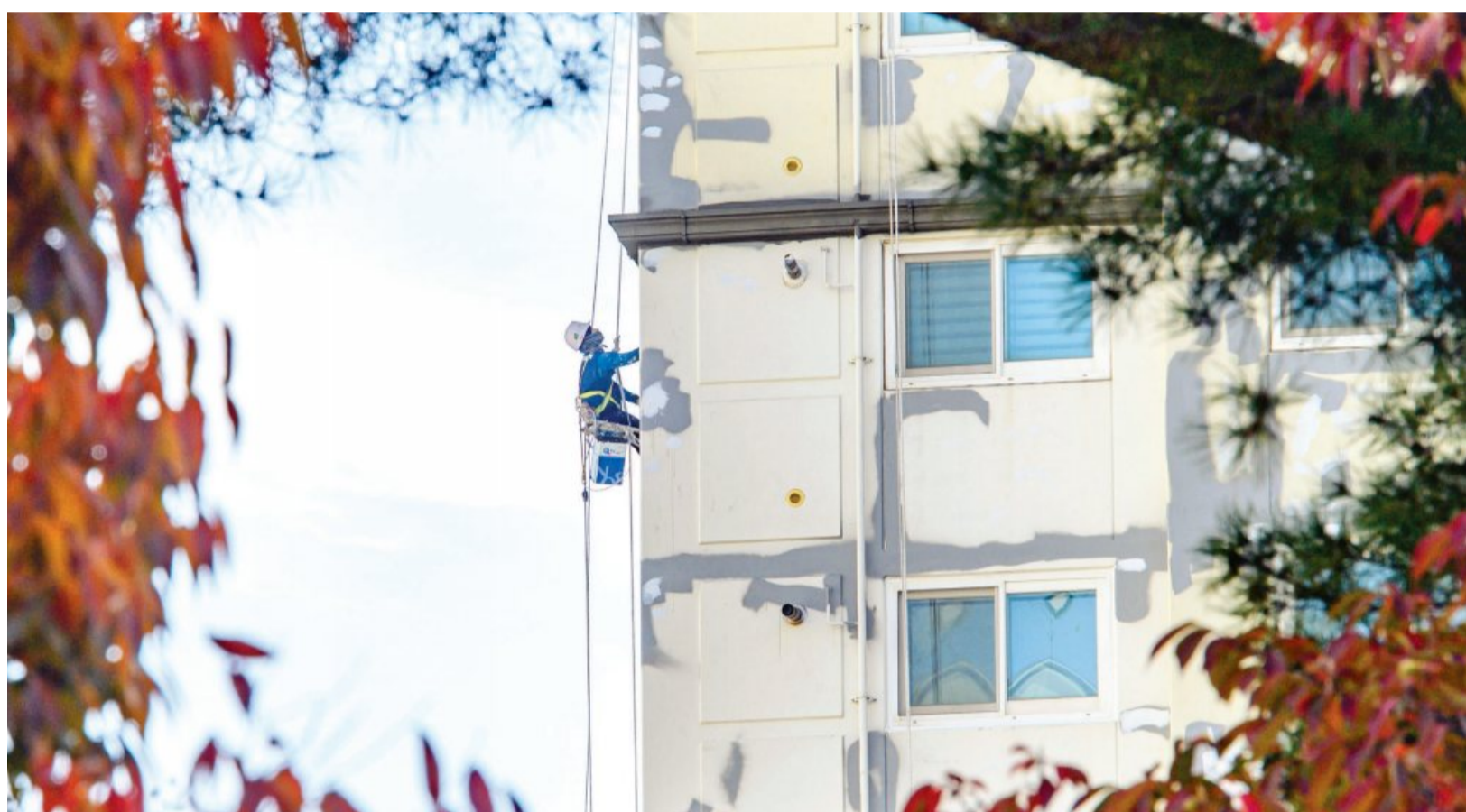
아파트는 단장 중 26일 오전 가을색으로 물들어 있는 광주 동구 푸른길의 나뭇잎 너머로 외출에 매달린 작업자가 아파트 외벽 도색 작업을 하고 있다. /김진수 기자 jeans@kwangju.co.kr
