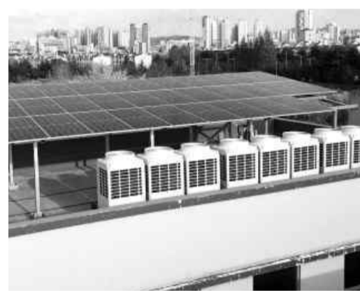
첨단도서관 옥상에 설치된 태양광 발전설비
