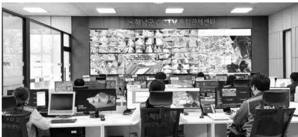
해남군 CCTV 관제센터.
